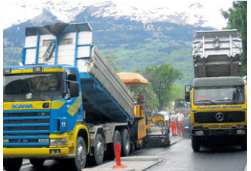
Keine Durchfahrt möglich: Die Meierhofstrasse in Triesen ist diese Woche teilweise gesperrt. Bild: paf1
